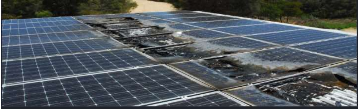
Fig.4.2. Faults in PV Array
